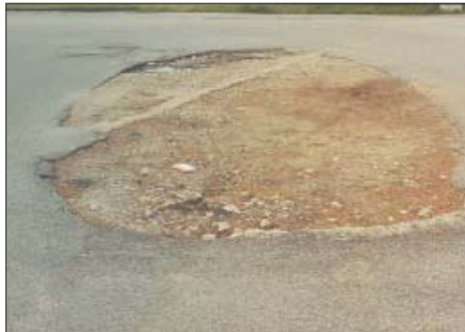
La buca sulla strada in località Pizzicato di Cinquefrondi
